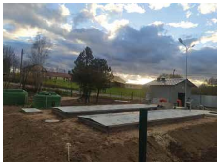
46. Oczyszczalnia ścieków w Skawie
